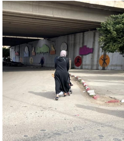
Photo 3 : Trottoir endommagé (N.Bakhti, 2023)
