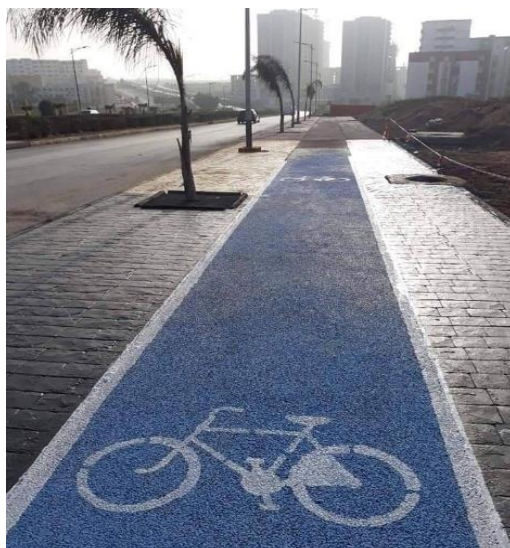
Photo 5 : 1 ère piste cyclable à Oran, Ouverte dans le cadre des Jeux Méditerranéens en 2022 (N. Bakhti, 2023)
